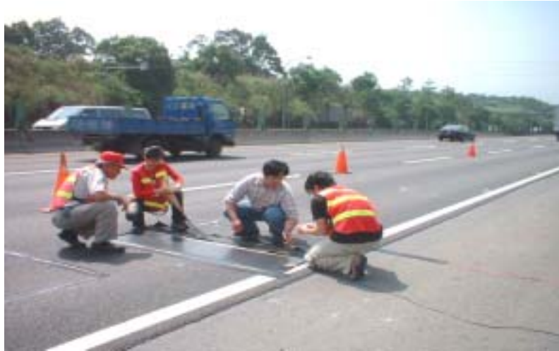
圖 3.2 動態地磅裝設情況
